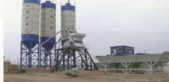
HZS75混凝土搅拌站
